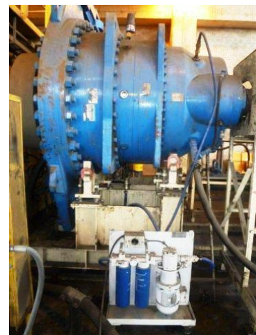
Figuras 9/10 – Válvula by-pass em filtro de óleo de redutores de velocidade
